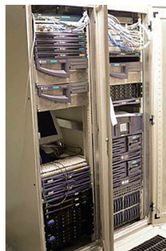
マークアイの使用している データセンターに格納されている TrusRAIDシリーズ
