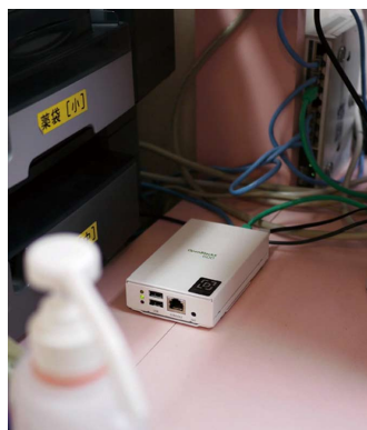
稼働中のS-Bridge System 筐体
