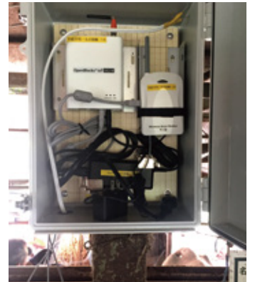
農場の配電ボックスに設置された OpenBlocks IoT VX2/W。低温・高温となる場所でも安定稼働できる。
